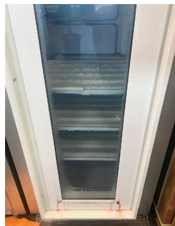
樹脂サッシの扉 アルミに比べると結露が少ないが、 ガラスにはかなり水滴がついている
