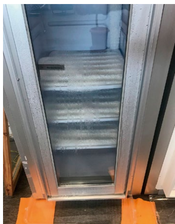
アルミサッシの扉 枠・ガラスともに結露の様子が はっきりと見て取れる
