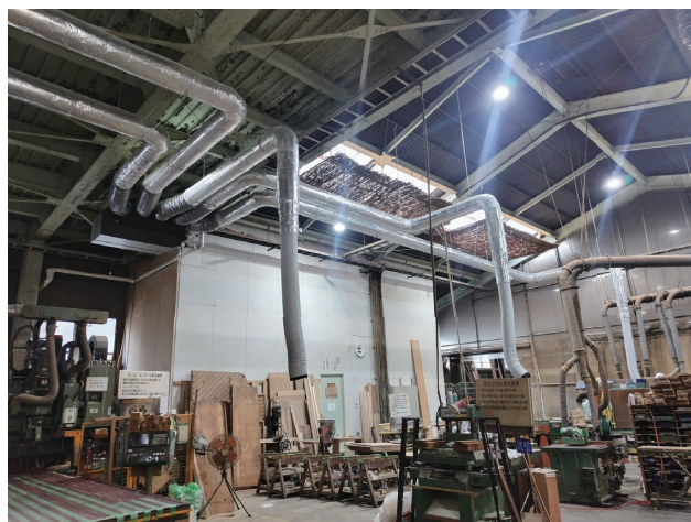
ジャバラの吹き出し口
