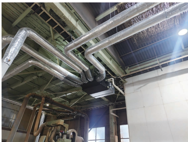
室内機から5本のダクトが出ています
