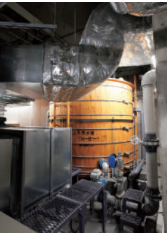
駐車場の奥の機械室内には檜製の受水槽が設置されています。
